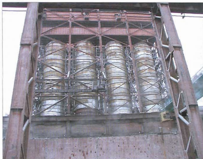
Рис. 1. Камеры установки замедленного коксования
